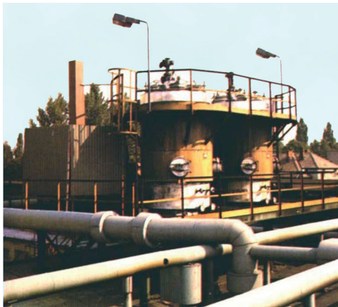
Ryc. 4.2.2 Instalacja „Swingtherm” do dopalania gazów odlotowych z emalierni
