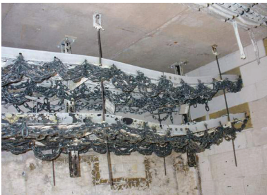
Widok tras kablowych po wygaszeniu ognia
